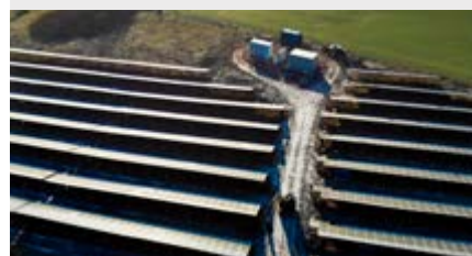
Solpark Skorteby, en hybridlösning på 3,2 MW solkraft kombinerat med 2 MW energilager, en del av Tekniska Verken i Mjölby kommun.
